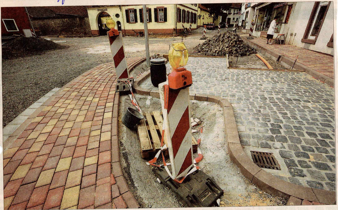
Die Straßenbauarbeiten im Nackenheimer Ortskern sorgen für Ärger. Vor allem die Geschäfte klagen über Einbußen. ■ Foto: Braun
